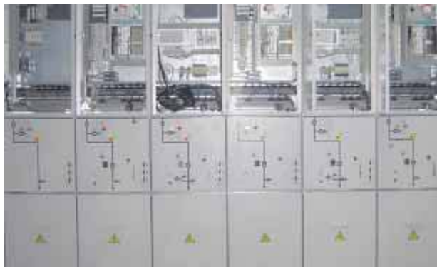
Slika 3.5.2 Ulazni razvodni uređaj
