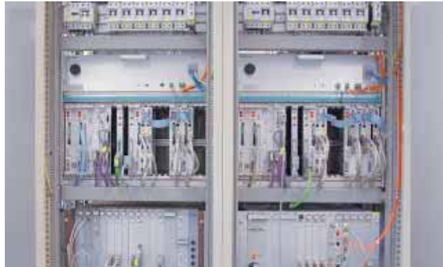
Slika 3.5.7 Orman sa opremom za PRC
