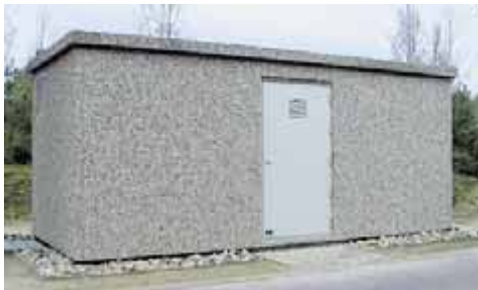
Slika 3.5.9 Izgled prekidačke stanice
